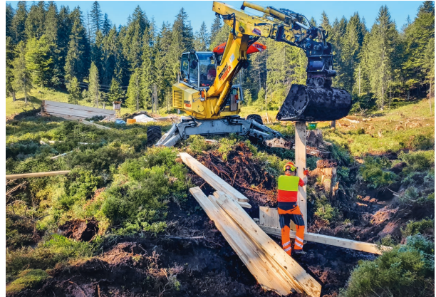
Mit Holzspundwänden werden Entwässerungsgräben verdämmt, um das Moor wieder zu vernässen. Aufnahme Kanton Luzern.
